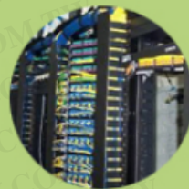
光纤通信机房
