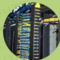
光纤通信机房
