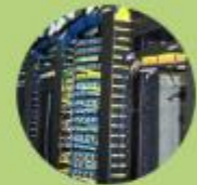
光纤通信机房
