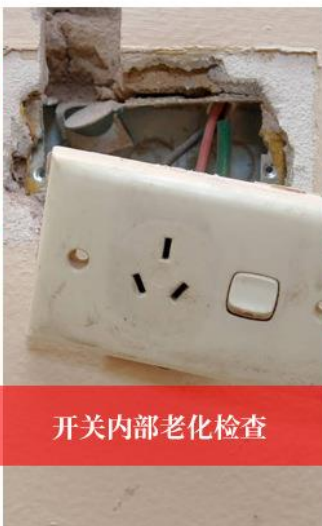
线路老化检查与排查
