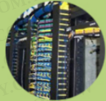
光纤通信机房
